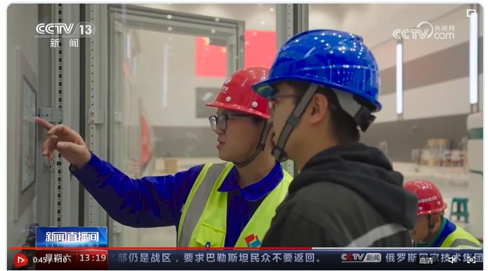
新疆阜康抽水蓄能电站系统本地监控与可视化
