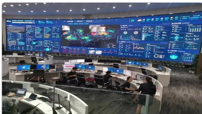
城市运行指挥中心融合通信系统
